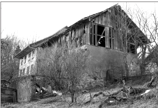
In den hölzernen Fassadenteilen klaffen grosse Löcher.
